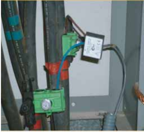
(Izquierda). En los centros de Transformación se instala un equipo cabecera PLC que gestiona las comunicaciones PLC con los modems de usuario a través de los cables eléctricos de baja tensión (típicamente 220/380 V), como el que se muestra en la figura
