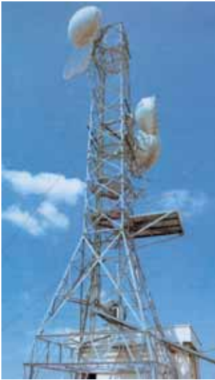
Torre de radioenlaces de la Red Integrada de Comunicaciones Oficiales (RICO), hacia 1990
