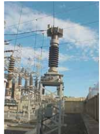
Bobina de bloqueo y transformado. Estos elementos se utilizan para acoplar la señal de alta frecuencia (ondas portadoras) a la línea eléctrica
