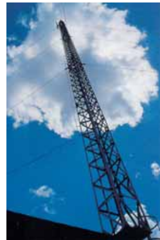
Mástil de antena rómbica
