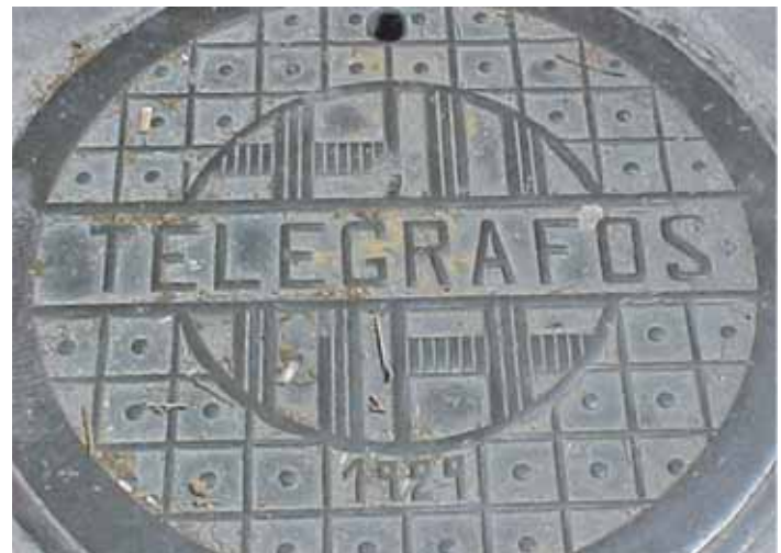
Tapa de canalización telegráfica de 1929 que aún puede contemplarse en Barcelona cerca de la salida del metro Barceloneta. La canalización sigue en uso para Telégrafos con un cable de fibras ópticas
