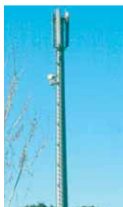
El rápido desarrollo de la telefonía móvil a comienzos del nuevo siglo XXI ha exigido la multiplicación de antenas como las de la fotografía que hacen posible la prestación de nuevos y mejores servicios
